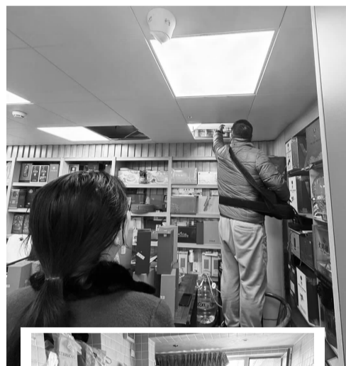
社区工作人员检查漏水原因
